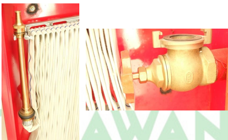
Gambar 4.6 Nozzle Hidran dan Gambar 4.7 Keran Hidran
